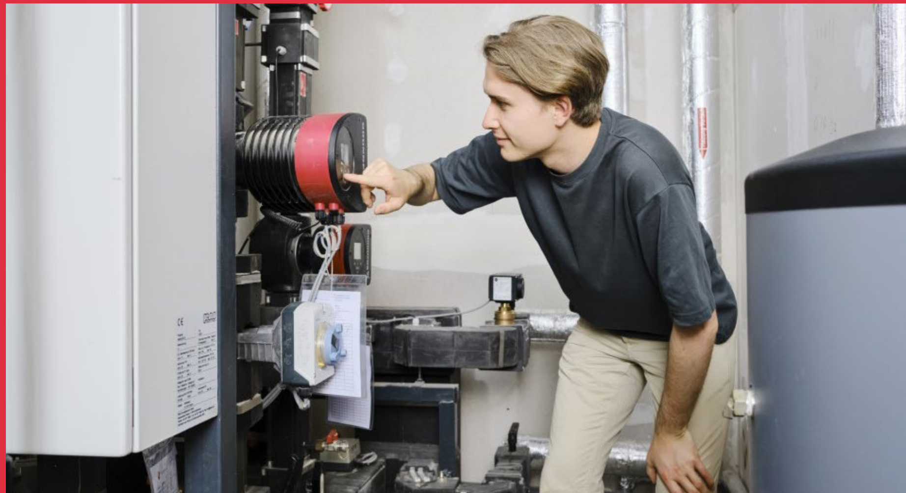
© GESOBAU AG / Verena Brüning: Heizungsanlagen – wichtiger Bestandteil im Programm unserer Auszubildenden
