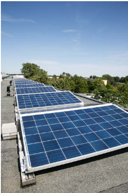
Hausgemachter Strom vom Dach im Pankeviertel. Bildquelle: GESOBAU AG / Christoph Schieder
