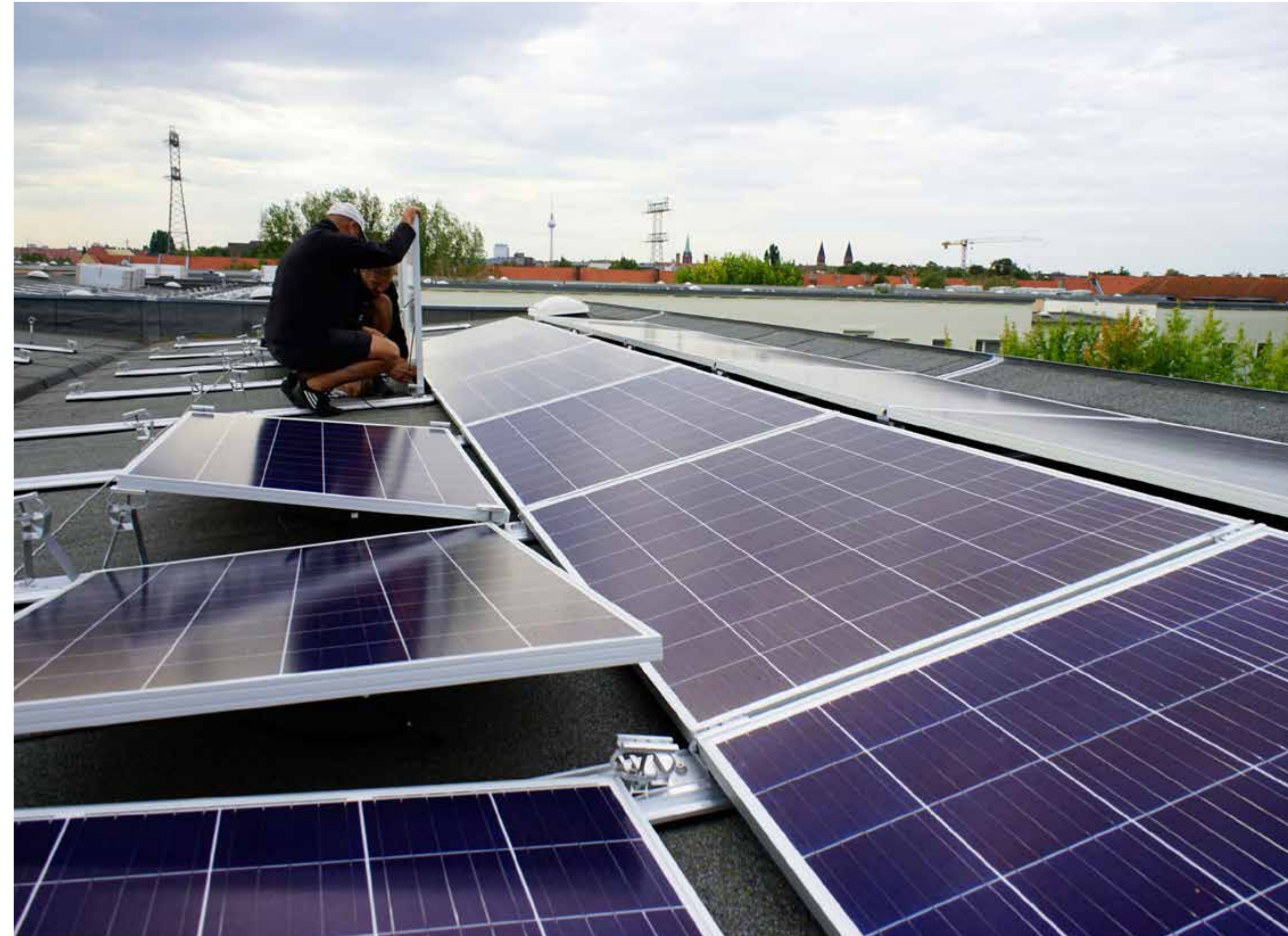
© Berliner Stadtwerke: Solardächer in der Neumannstraße in Pankow
