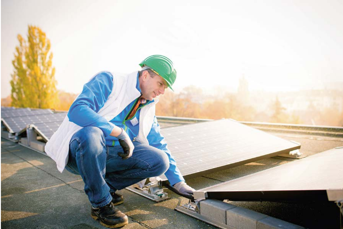
Jetzt fließt der erste Mieterstrom von einem GESOBAU-Dach
