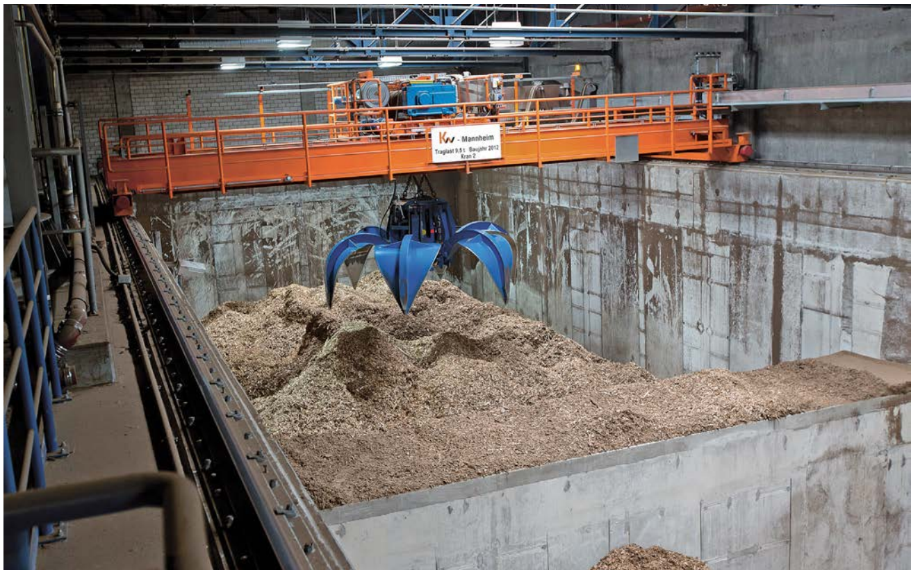
Unser zentraler Wärmeversorger, das Fernheizkraftwerk Märkisches Viertel, arbeitet seit diesem Jahr mit einer Kraft-Wärme-Kopplungsanlage mit Biomasse
